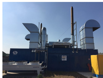
Figure 3 - moteur de cogénération d'électricité
