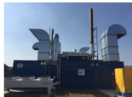
Figure 3 - moteur de cogénération d'électricité
